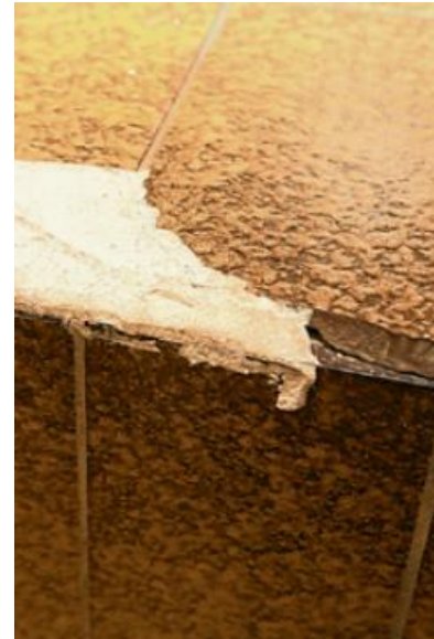
Schäden gibt es viele in der Mittelschule, hier der Treppenabgang zur Turnhalle. Nun wird saniert. Foto: Mathias Wild
